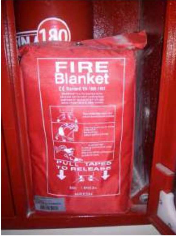
Resim 7.1.27. Yangın dolabı ve bina etrafı hidrantlar
